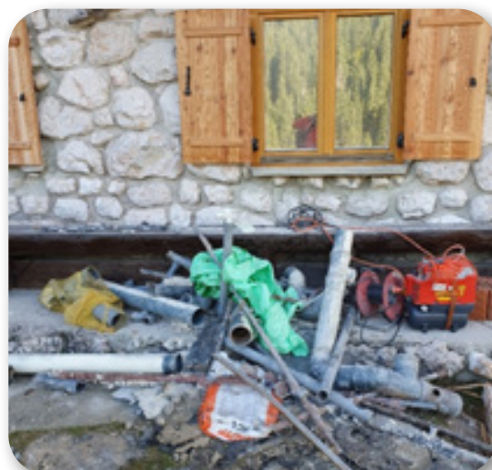
Ruševine vodovoda in kanalizacije
