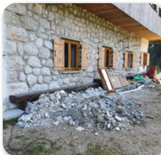
Ruševine izkopanega tlaka in ometa
