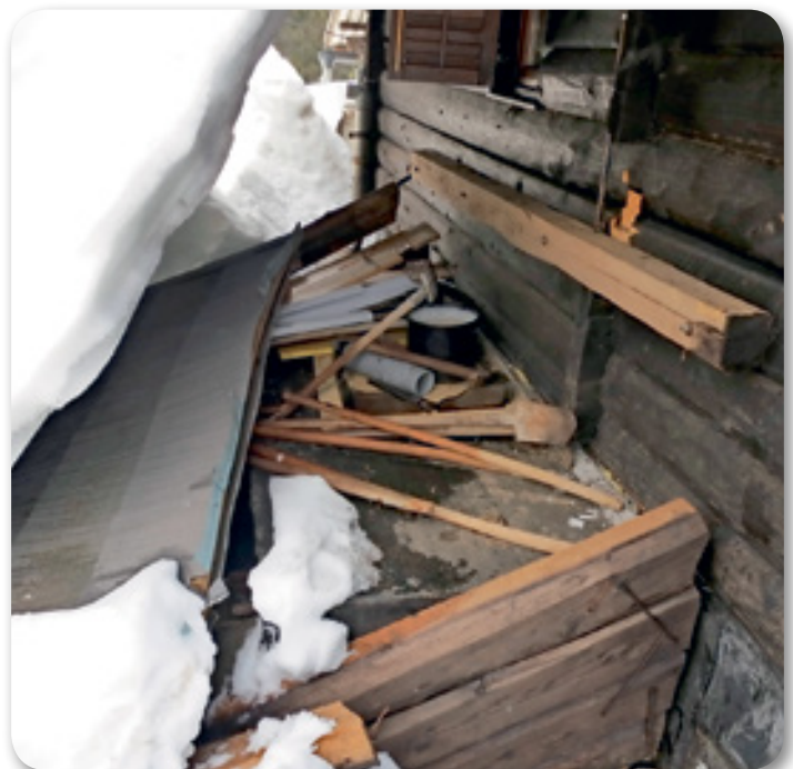
Nadstrešek nad vhodom v klet brunarice se je izpulil iz prečnega trama in zdrsel dober meter navzdol.
