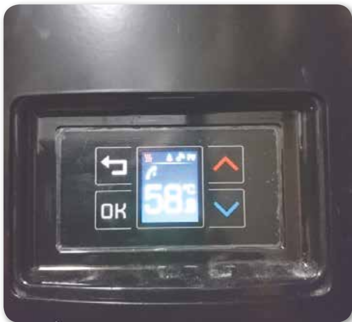
Toplotna črpalka zagotavlja 300 l vode, segrete od 40 – 60 °C
